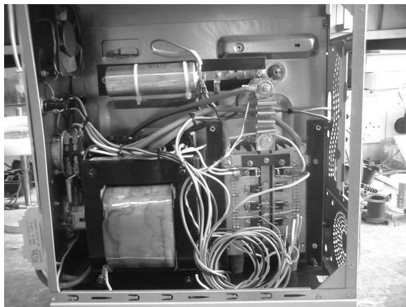
Слика 4. Инвертор 300 VA – стара конструкција
